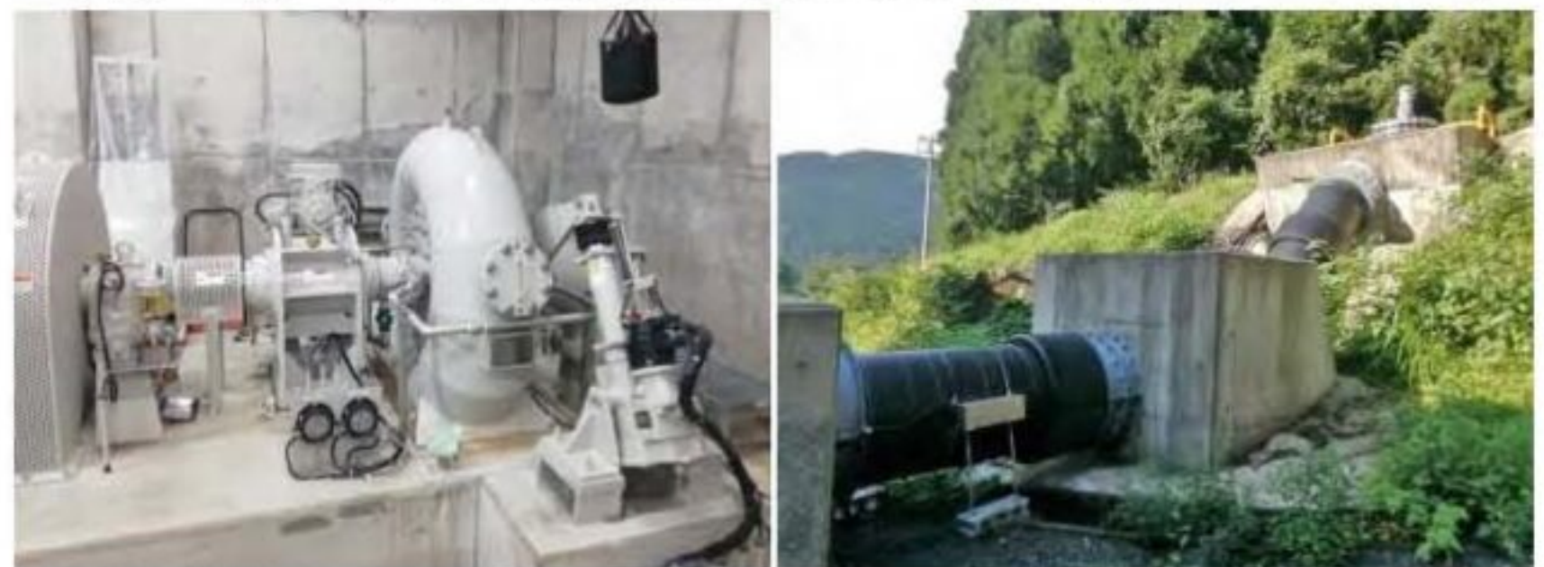
宇津尾谷川小水力発電所のフランシス水車(左)と導水管
